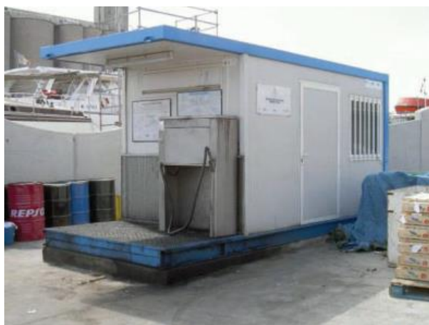
Figura 9: Módulo de almacenamiento de aceites en el punto limpio del puerto de Tarragona.
