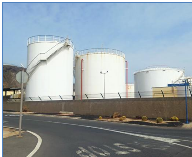
Tanques de la planta de regeneración de aceite
